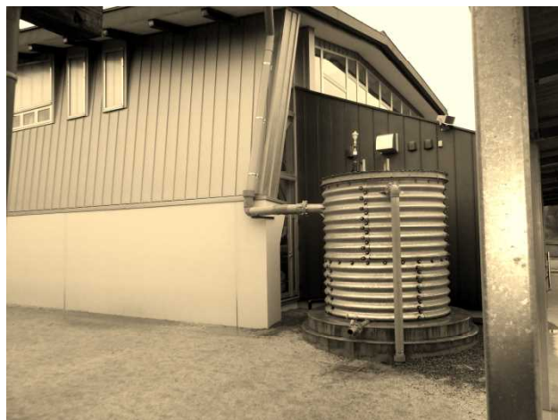
体育館そばに設置されている雨水タンク
